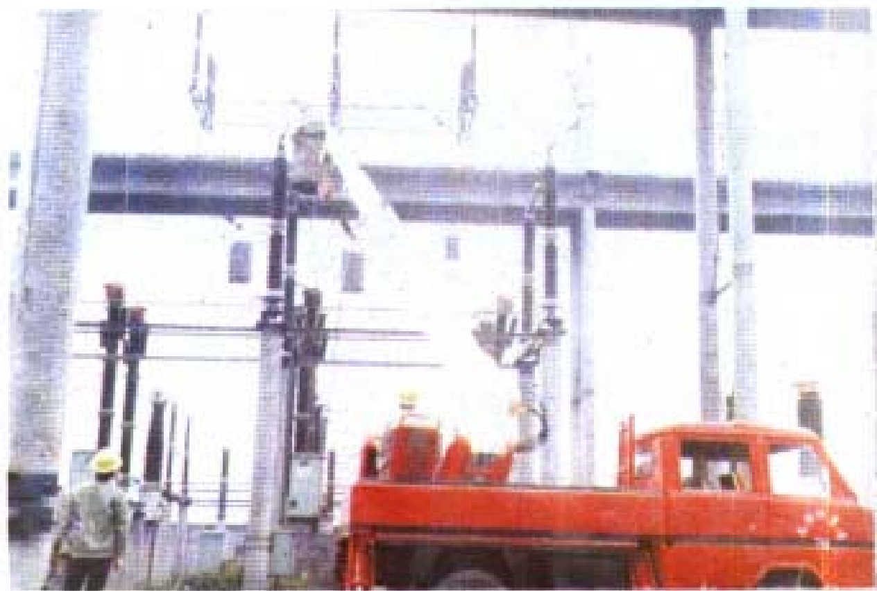
公私合营时组建成都启明电气公司,后发展为成都 供电局。图为今日成都供电局的高压输电线路。
